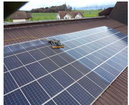
Le nettoyage des installations solaires est effectué par un robot de nettoyage.
